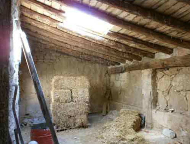
la partie dont le toit a été refait, avec une isolation terre/paille
