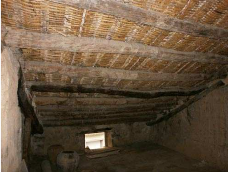
la partie dont le toit est à refaire
